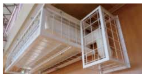
学校体育館の空調設備
